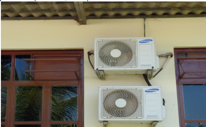
Figura 01. Aparelho de ar condicionado
