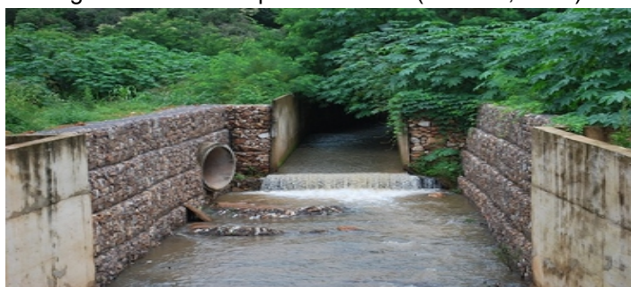
Figura 01. Canalização do Córrego Pernada
