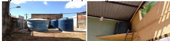
Figura 1. Sistema de captação da água da chuva.
