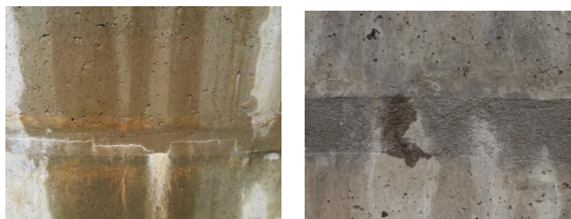
Figura 01. Infiltração nas juntas dos anéis de concreto (parede inferior e superior, respectivamente).
