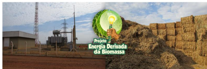
Figura 3 - Subestação Elétrica da Codora Energia, Logotipo do projeto e fardos de palhiço de cana
