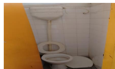
Figura 4. Condições dos banheiros
