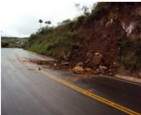
Figura 2 - Deflagração de um talude atingindo parte da rodovia na MGT 482, no município de Conselheiro Lafaiete. FONTE: [6]
