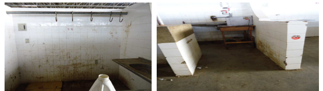
Figura 01: estado de piso e paredes dos boxes que comercializam carnes no Mercado Público no município de Salgueiro PE
