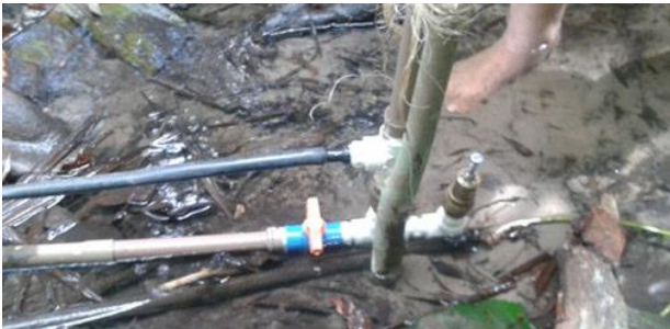
Figura 5 - Carneiro hidráulico instalado no assentamento Mártires da terra.
