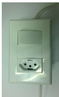
Figura 02- interruptor com sistema instalado
