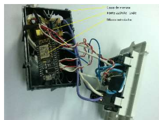
Figura 01- caixa de passagem com o Sistema instalado
